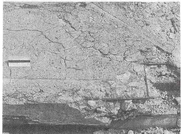
写真7 コンクリート製品の劣化状況
